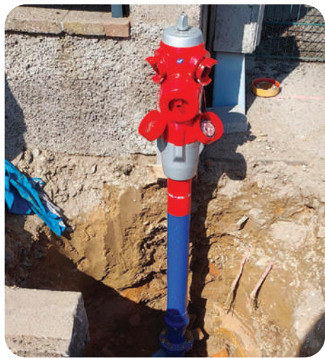
Un poteau d'incendie
